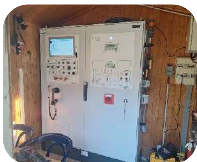
Changement de l'armoire de commande
