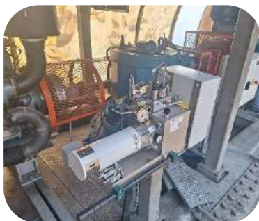
Mise en intermittence de la centrale hydraulique de tension
